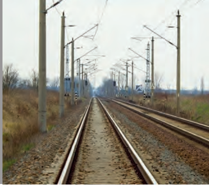
Oberleitungs-Betonmasten an einer Eisenbahnstrecke © Uwe Bumann - Fotolia
